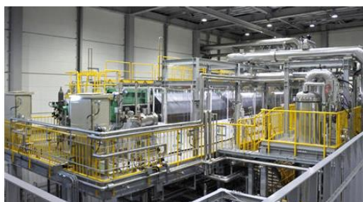
10MWの水電解装置
