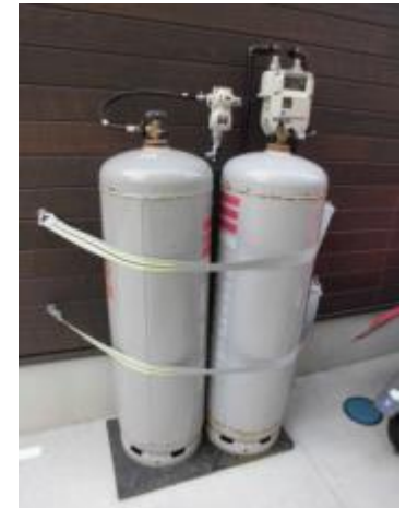
軒下に50kg のガスボンベ (ベルト2重巻き)
