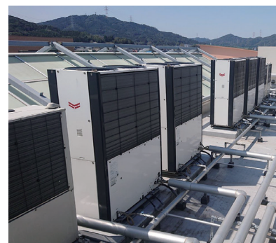
屋上に設置したGHP
