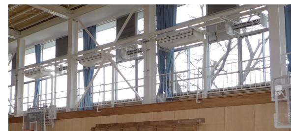
体育館内のGHP室内機(大野小学校)
