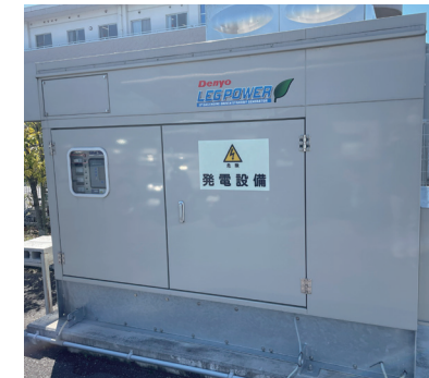
非常用発電機
