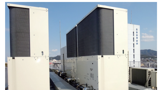
屋上に設置したGHP
