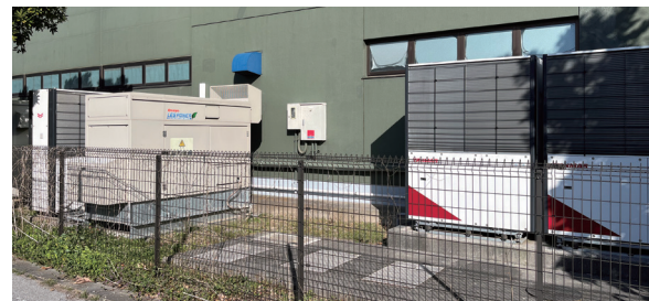
GHP室外機と非常用発電機
