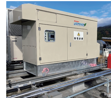
非常用発電機
