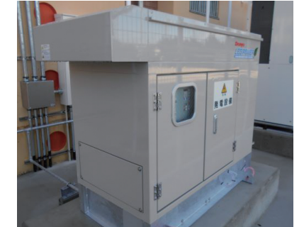
非常用発電機
