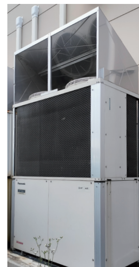
防雪フードがついたGHP室外機
