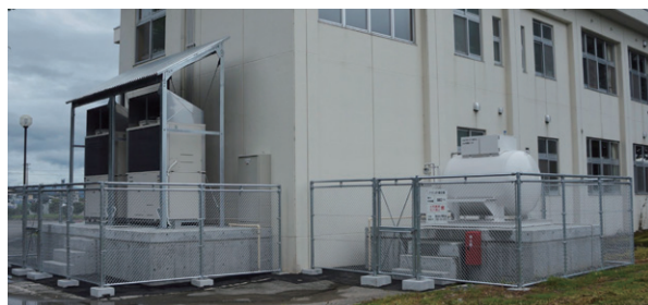
大森小学校に電源自立型GHPを2台設置した
