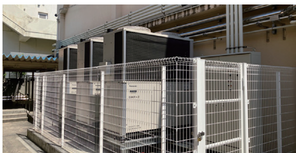
電源自立型GHPを体育館に設置した(養精中学校)
