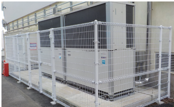
電源自立型GHPを導入した高野小学校
