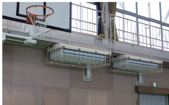
新川中学校体育館に設置した室内機
