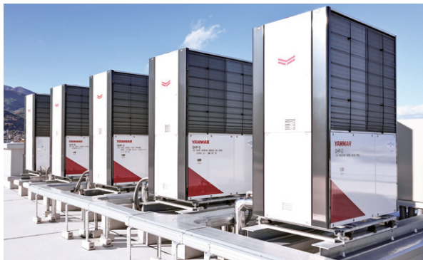
庁舎屋上に設置したGHP
