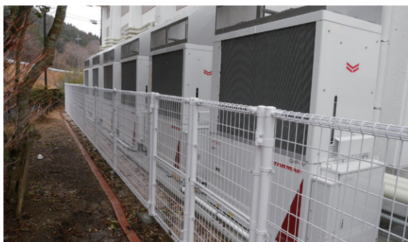
電源自立型GHP（城山中学校）
