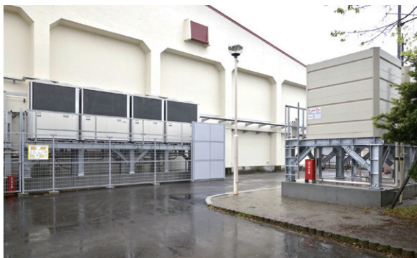
かさ上げ設置したGHP室外機とバルク貯槽（新川中学校）
