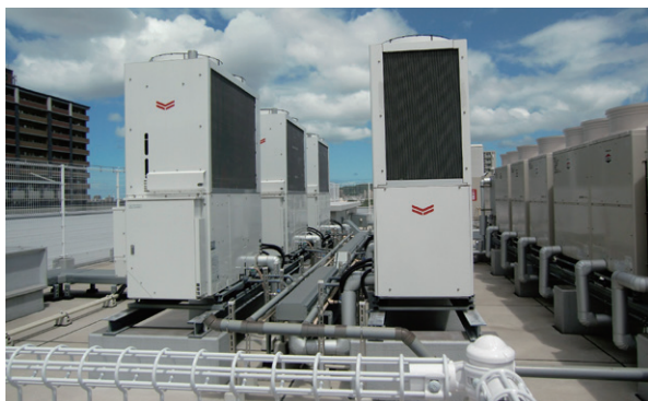
金池小学校体育館屋上にある電源自立型GHP
