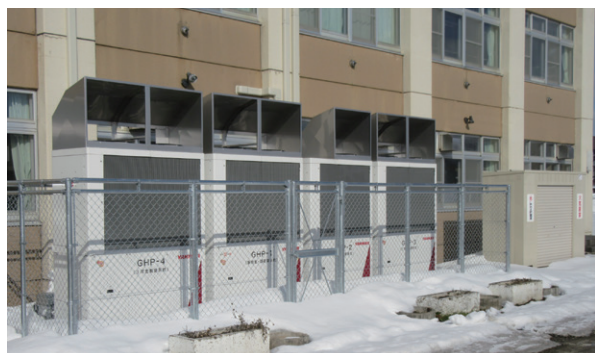
防雪フードが付いた室外機（美唄中学校）
