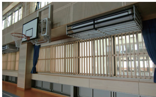
室内機は館内左右に各6台設置（金池小学校）
