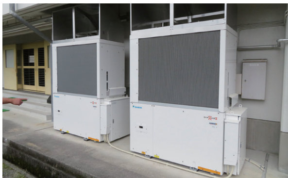
電源自立型GHPを採用した（下條中学校）
