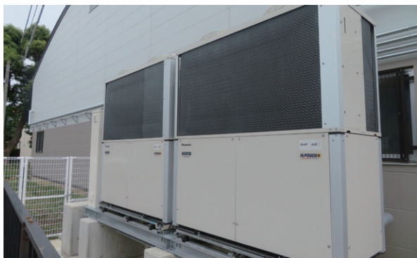
電源自立型GHP（川越第一中学校）
