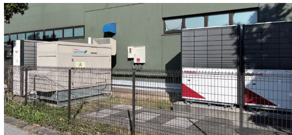
GHP室外機と非常用発電機
