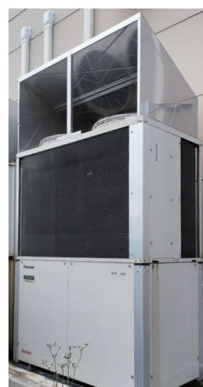
防雪フードがついたGHP室外機
