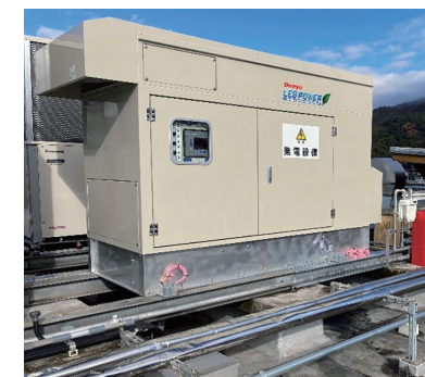
非常用発電機
