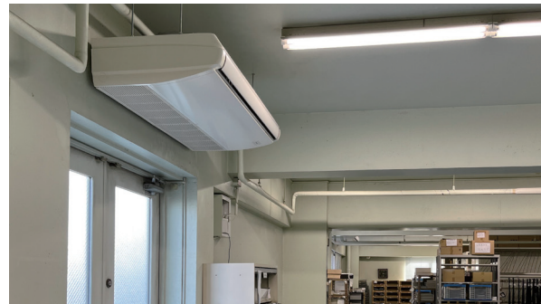
快適なGHP空調で職場環境を改善
