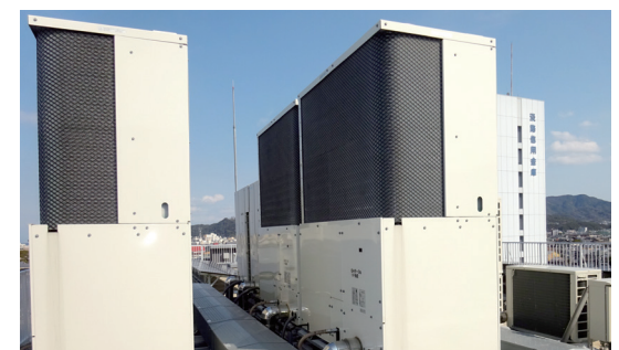
屋上に設置したGHP
