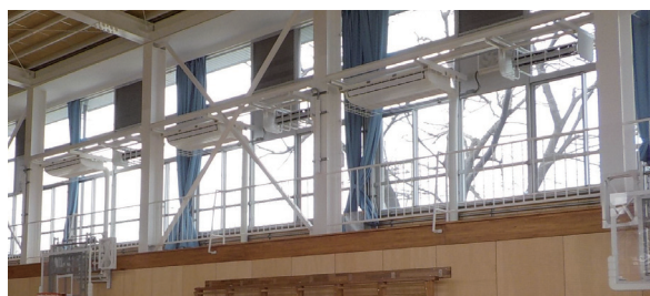
体育館内のGHP室内機(大野小学校)
