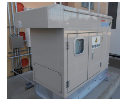
非常用発電機
